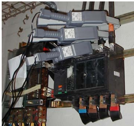
Figure 1.2 : Pinces ampèremétriques utilisées pour le suivi des départs de tableaux électriques
